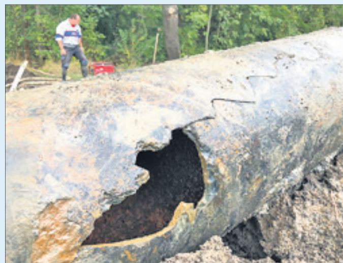
20 cm breit, 10 cm hoch – das Loch in der Fernwasserleitung war beträchtlich und innerhalb kurzer Zeit war die Leitung leergelaufen.
