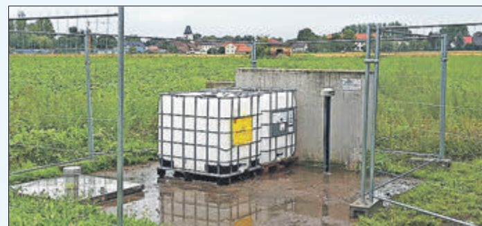
Unscheinbar, aber effektiv: In diesen Behältern am Pumpwerk Friedensdorf wurden die Klärwerksschlämme gelagert und in regelmäßigen Abständen in den Abwasserstrom der Druckleitung zur Kläranlage gepumpt.
