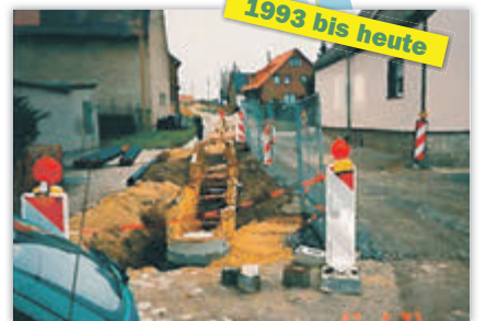
Abwassertechnische Erschließung der Ortsteile Burgwerben, Tagewerken, Reichardtswerben, Bora (im Bild) und Langendorf.
