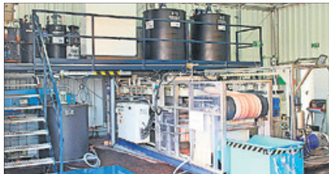
Die Hamburger Pilotanlage ging im Sommer 2015 in Betrieb. Foto: REMONDIS
