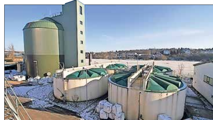
Das im vergangenen Jahr aufwändig modernisierte Klärwerk am Saaleufer in Weißenfels ist das viertgrößte seiner Art in Sachsen-Anhalt und ermöglicht Industrieansiedlungen im großen Stil.
