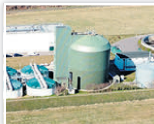
Kläranlage Weißenfels: Im Faul-turm wird Gas für die Blockheiz-kraftwerke gespeichert. Foto: Abwasserbeseitigung Weißenfels-AöR
